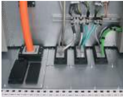
Kaapeleiden läpivienti moduulilaipan avulla TS 8 kaapissa. KDR-BMP
